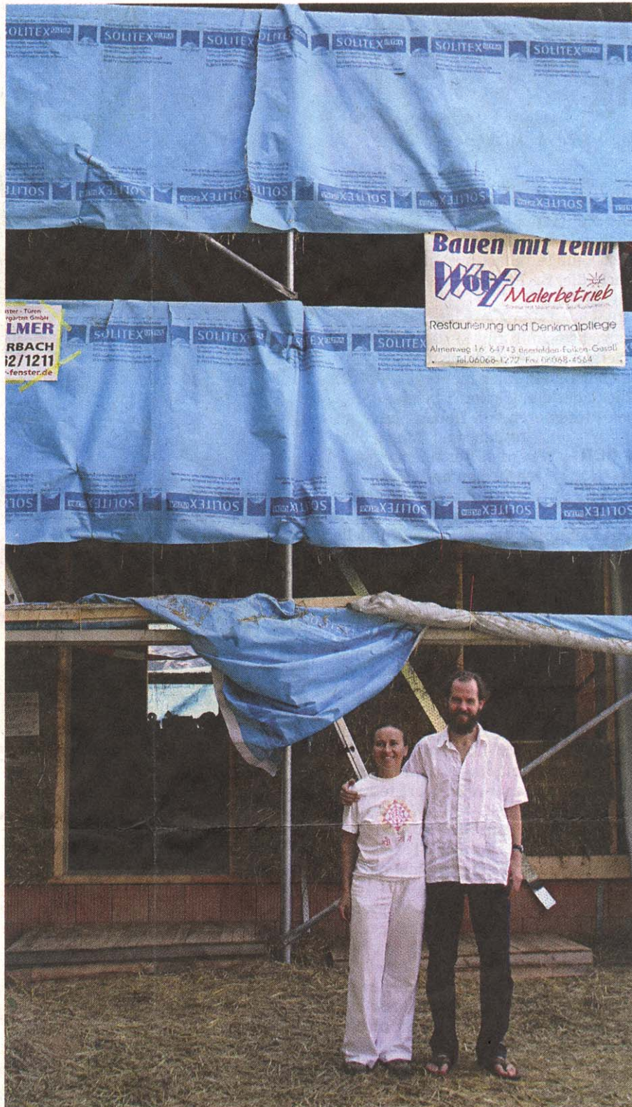
Susanne Körner und Tilman Schäberle sind stolze Hausbesitzer der ungewöhnlichen Bauart. Ihr Strohhallenhaus ist das erste in Hessen.
